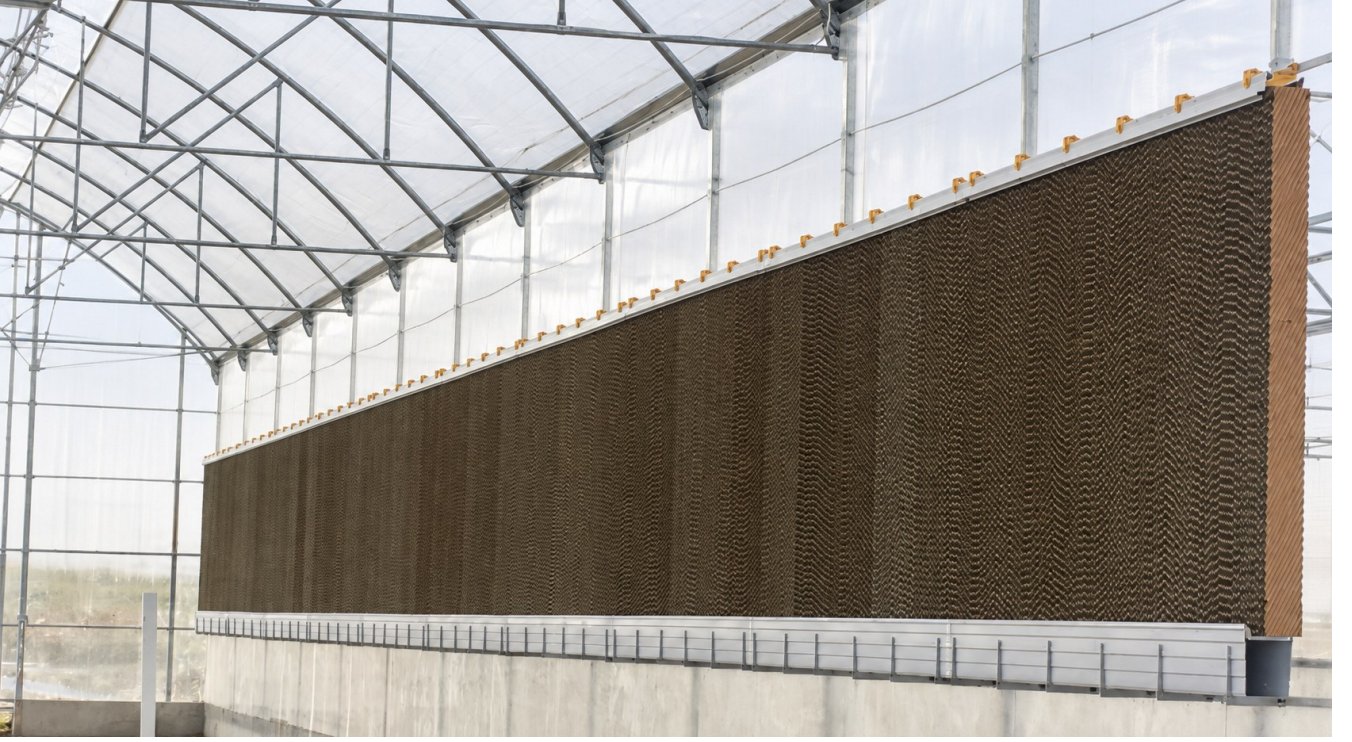
Sera içi evaporatif soğutma pedi ve su toplama kanalı
